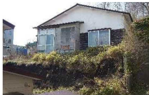
コンクリート擁壁が 手入れされていない土地
